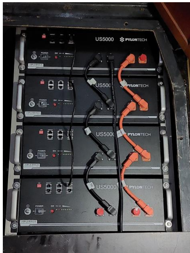
Die Batterien sind montiert und parallel geschaltet.
